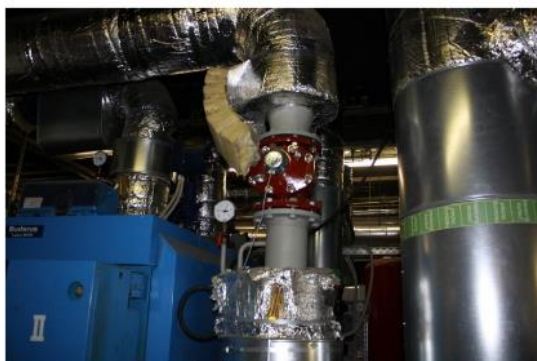
Centrale thermique de l'école à isolement défectueux.
