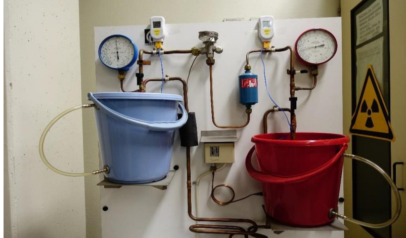
Mesure de la température dans le modèle de pompe à chaleur pour le calcul de rendement.
