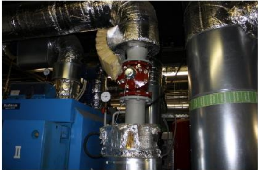
Central térmica de la escuela con aislamiento defectuoso.
