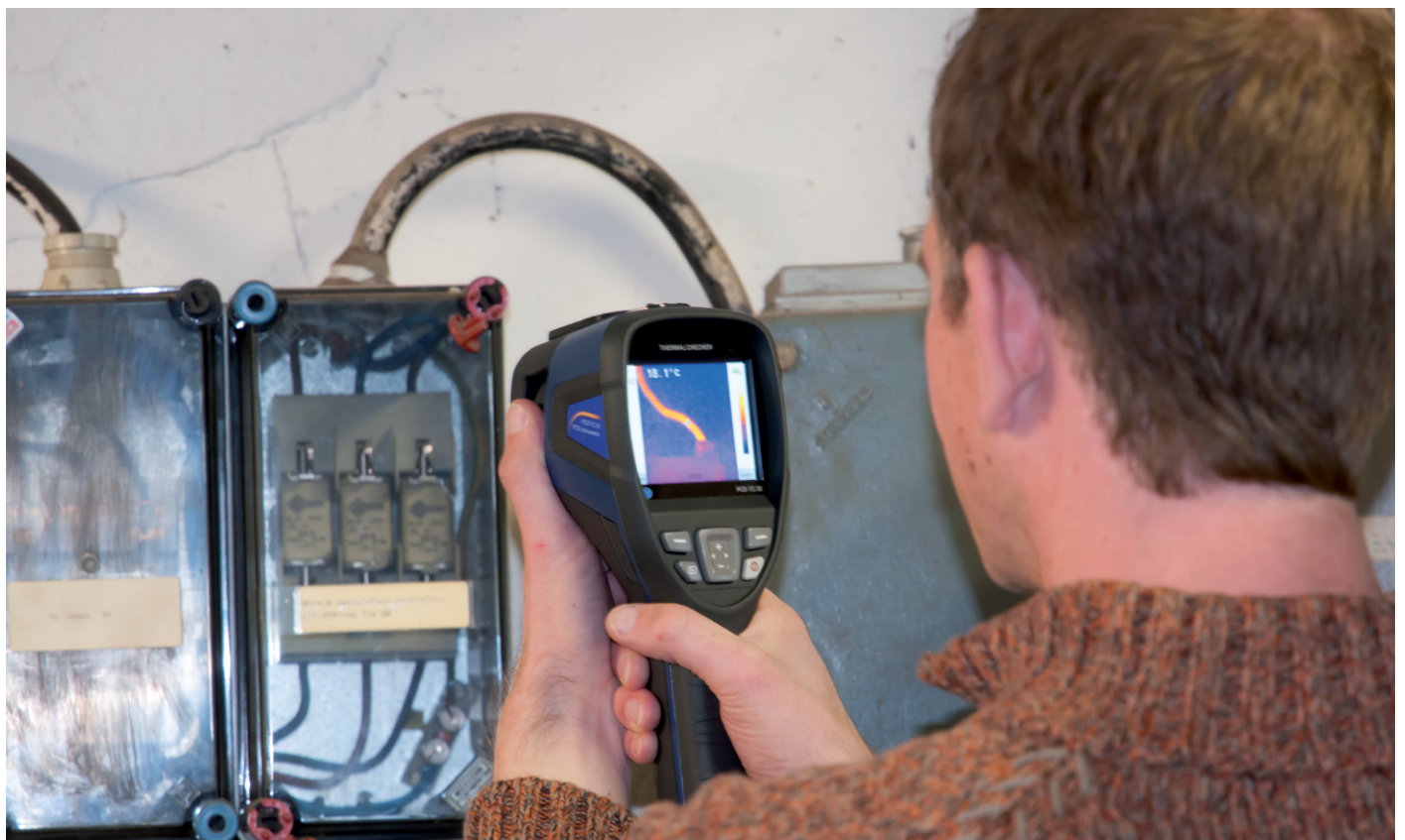
Kontrolle am Stromverteiler
