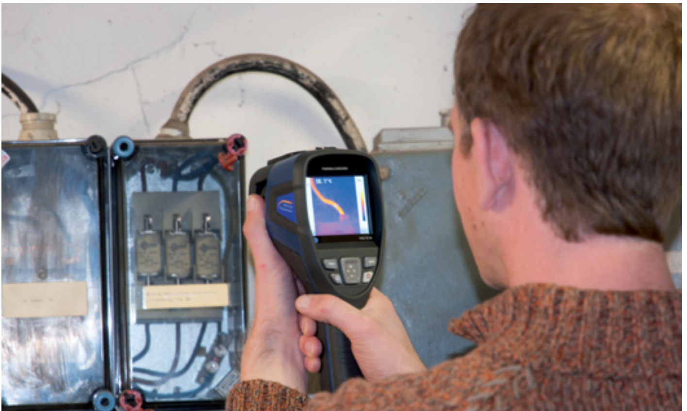
Kontrolle am Stromverteiler
