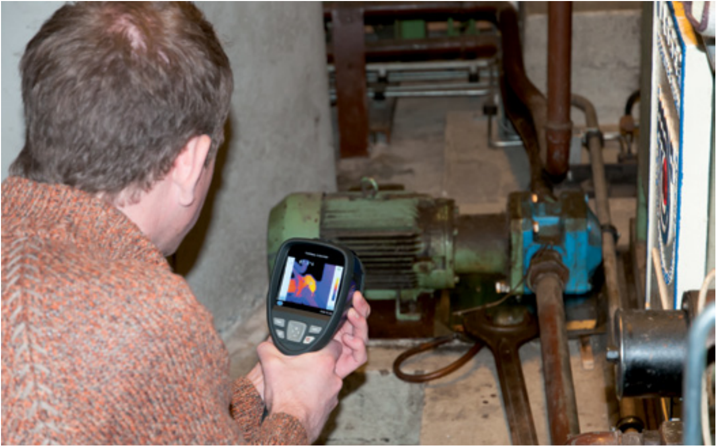
Inspektion von Motoren
