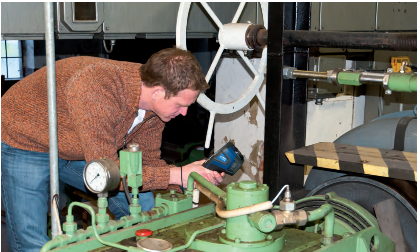
Wartung der Generatoren im Wasserkraftwerk mittels Infrarotthermometer / Wärmebildkamera
