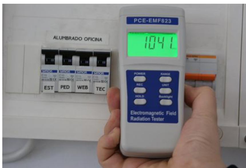
Comprobación de la radiación magnética en un cuadro eléctrico con el gaussímetro.
