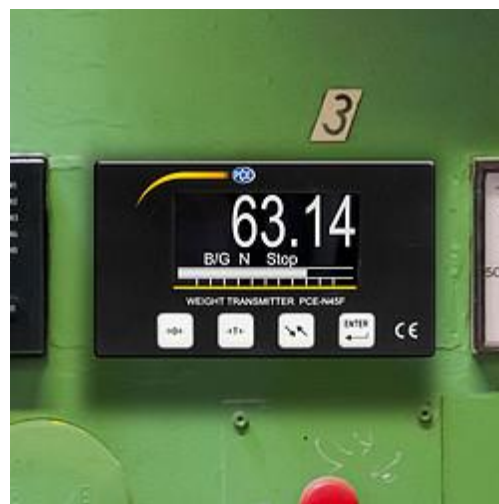
Display ingebouwd in paneel
