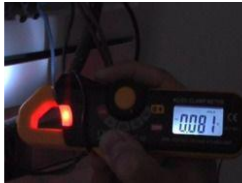
Voltage meting van een elektrisch paneel in omstandigheden met weinig licht.
