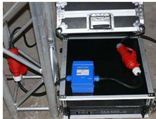
Der mobile Drehstromzähler Easycount als Zwischenzähler vor einer Verstärkeranlage.
